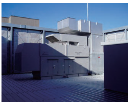
防音壁内面は吸音材(左は発電機)
