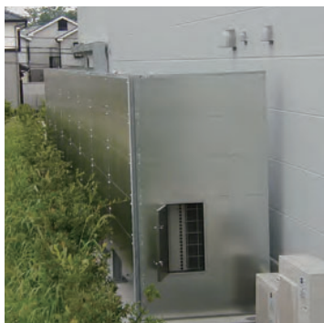
室外機を防音壁のみで対策(右は内部)
