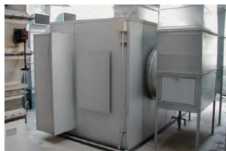
機械室内設置のファンへ防音ケーシング
