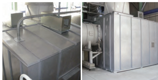
ファン防音ケーシング(大型のため現場組立タイプ) 屋根部には消音器付きの給排気口
