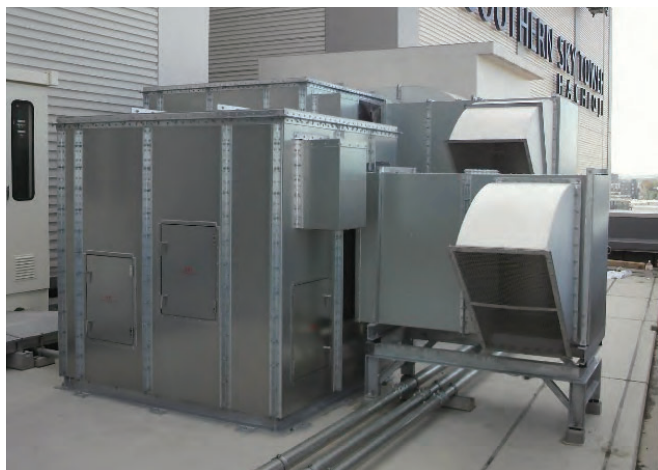
ファン防音カバーと吐出消音器
